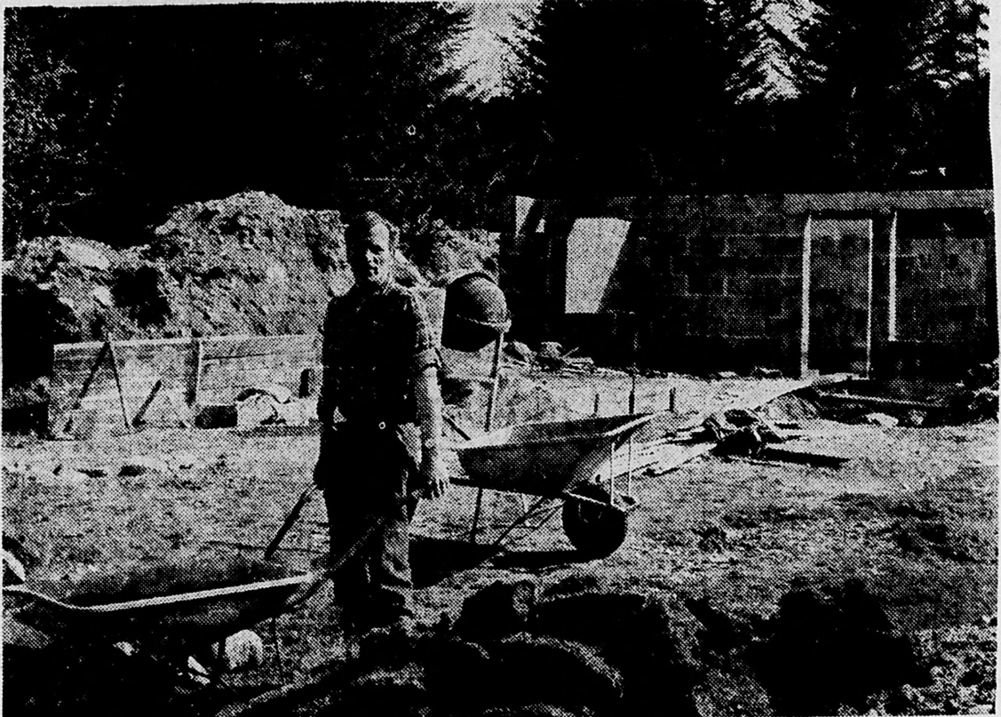
Kåre Sørveik er frå Brandasundet, men no vil han busetja seg på «fastlandet». Han er i full gang med husbygging.
